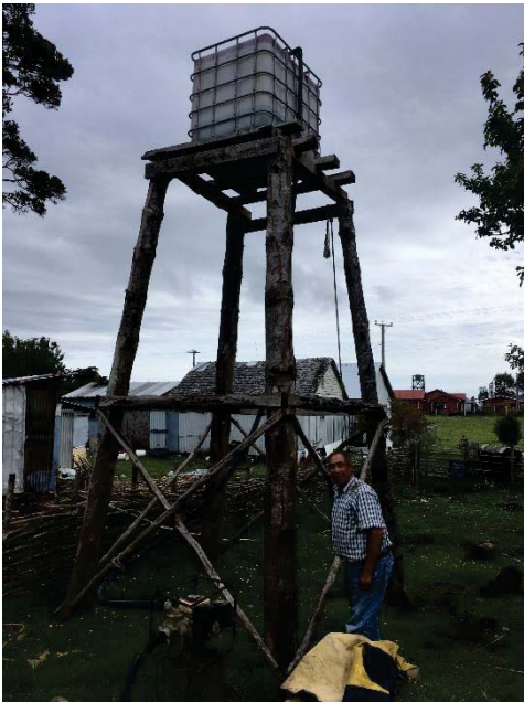
Fotografía 11: torre de agua y motobomba de sector bajo de la isla.
