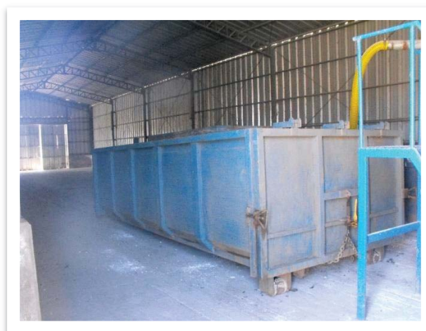
Figura N° 2.15: Contenedor de lodos inertes o encalados. (PTAS – Lanco)
