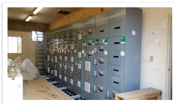
Figura N° 2.5: Centro de control de motores de la planta. (PTAS Los Muermos)
