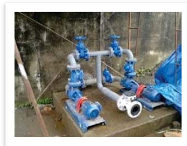
Figura N° 2.9: Equipos de bombeo para purga de lodos hacia el espesador. (PTAS – Los Muermos)
