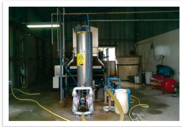
Figura N° 2.13: Filtro de bandas para deshidratado de lodos. (PTAS – La Unión)
