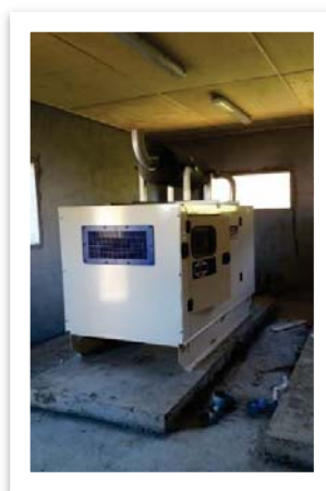
Figura N° 2.6: Grupo generador de respaldo de energía para equipos. (PTAS Los Muermos)
