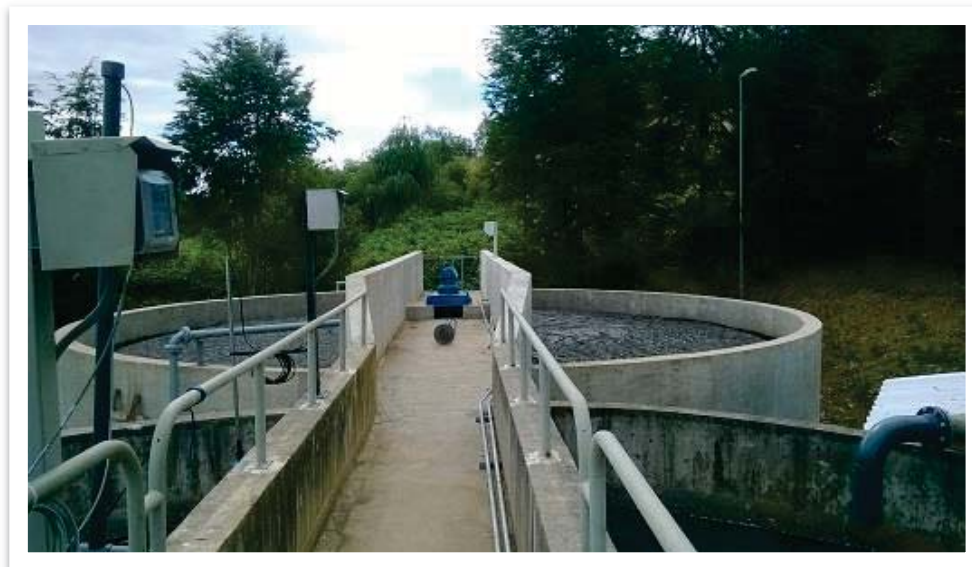
Figura N° 2.10: Estanque y motor de espesador de lodos. (PTAS – La Unión)
