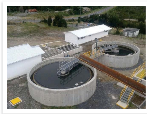
Figura N° 2.8: Estanques sedimentadores de lodos (PTAS – Chaitén)
