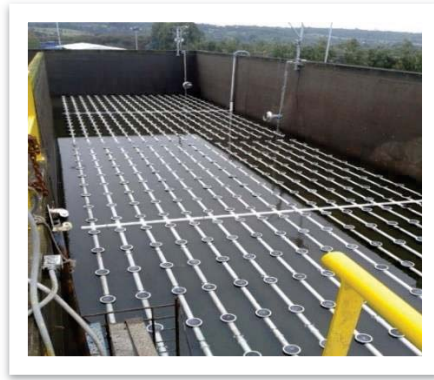
Figura N° 2.7: Estanque reactor (PTAS - Quellón)
