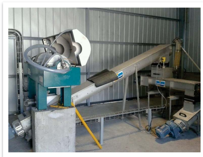
Figura N° 2.14: Centrifuga, bomba de tornillo y mezcladora para encalado. (PTAS – Chaitén)
