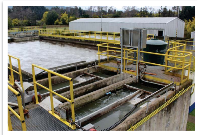
Figura N° 2.2: Planta de Pre-Tratamiento de Aguas Servidas ESSAL La Unión – Eliminación de Grasa y Arena.
