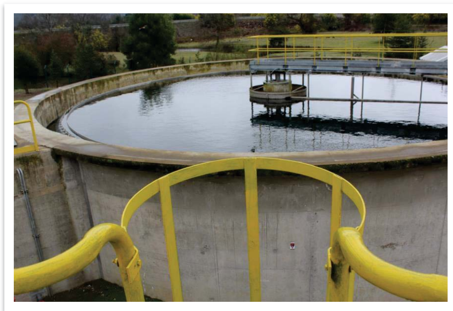
Figura N° 2.4: Planta de Pre-Tratamiento de Aguas Servidas ESSAL La Unión – Estanque Decantador.
