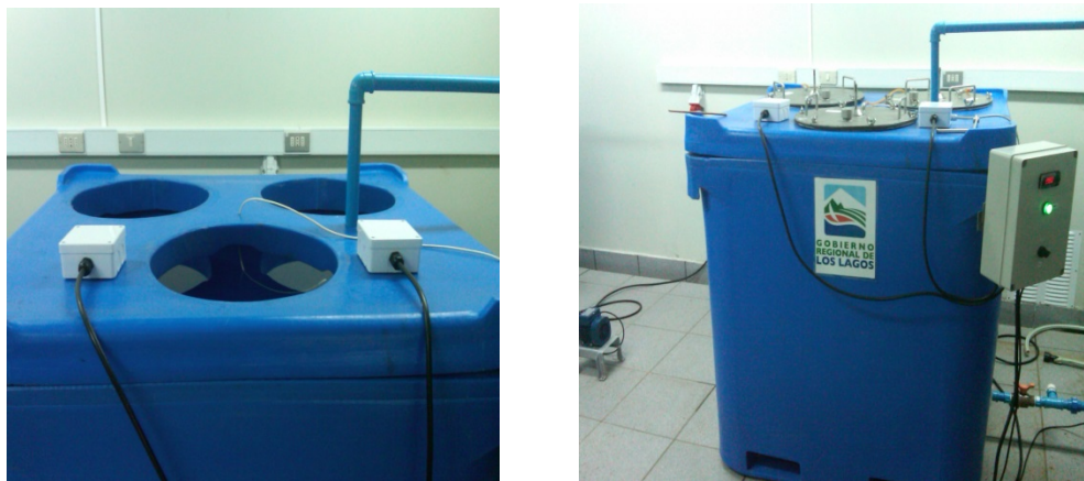
Figura N° 25: Estructura de digestión anaerobio.
