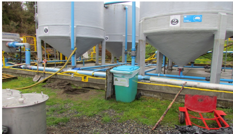
Figura N° 20: Conos de sedimentación en piscicultura de recirculación
