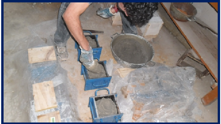
Figura 13: Operación de llenado de los recipientes con mortero de hormigón (Elaboración propia).
