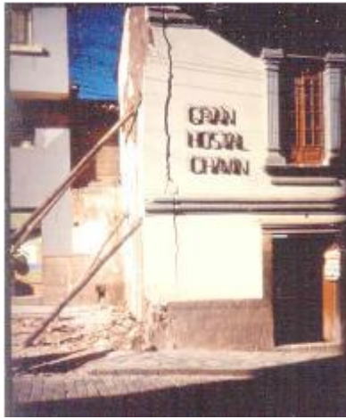
Fig. 2.1: Separación entre la esquina y el muro de un edificio de adobe a causa de su falta de sistemas de conexión (Blondet et al., 2003).
