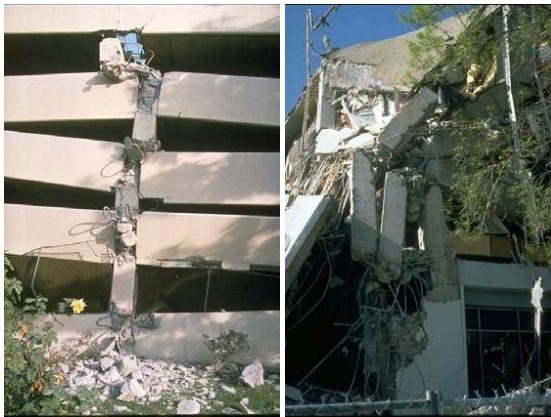
Fig. 2.4: Falla en las columnas y en las juntas. Terremoto Northridge, EEUU (Mohele, 2000).
