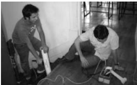
Fig. 2.2: Uso del Resistograph en una escalera de madera. Edificio Sao Domingos, del siglo XIX (1856), en Porto, Portugal (Ilharco et al., 2008).
