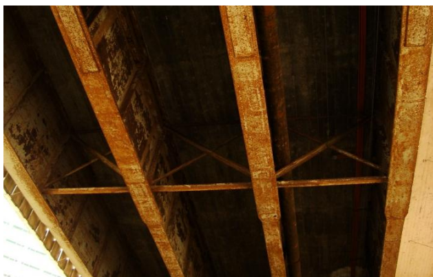
Figura 4. 23: Oxidación superficial en viga metálica
