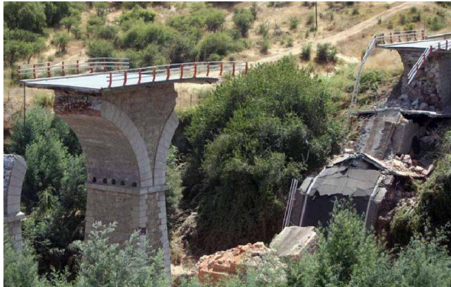
Figura 1. 14: Puente colapsado sobre el río Claro, Región del Maule. Fuente: Dávila, M., 2010.
