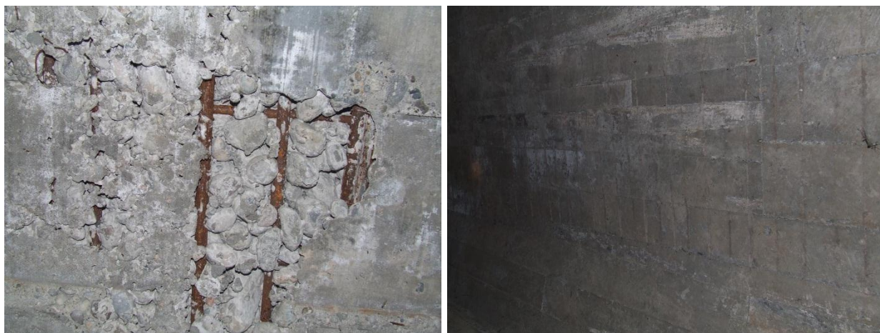
Figura 4. 18: Acero de refuerzo expuesto al medio ambiente. A la izquierda: armadura expuesta por disgregación del hormigón. A la derecha: armadura expuesta por falta de recubrimiento de hormigón. Fuente: Cortesía Frank Schanack.
