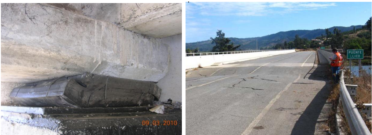
Figura 2. 15: A la izquierda: Paso inferior La Ballena, deformación de la placa de apoyo. A la derecha: Puente Llco, descenso terraplén de acceso. Fuente: Ministerio de obras públicas, 2010.
