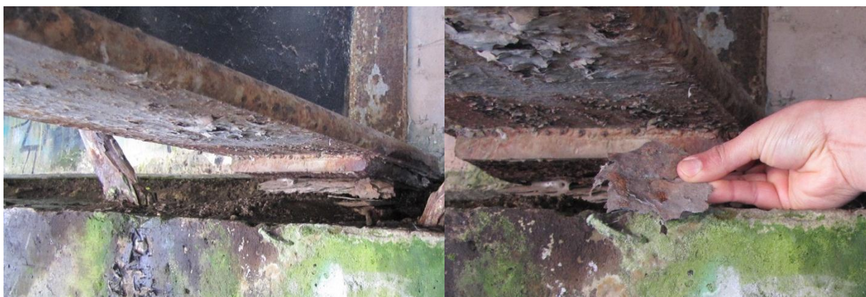
Figura 4. 24: Corrosión ambiental en apoyo de viga.
