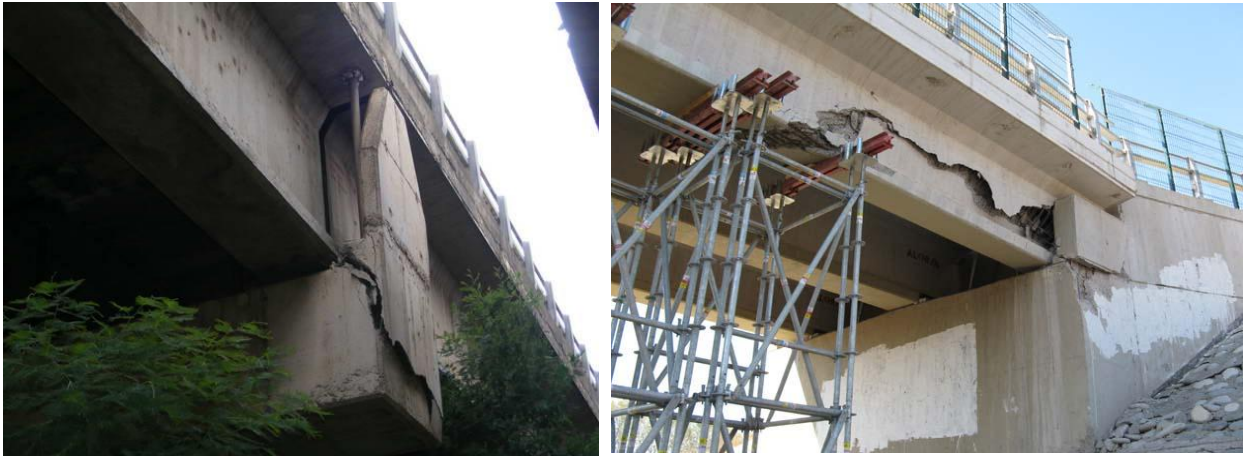
Figura 2. 13: A la izquierda: Puente Nuble Oriente, daño tope sísmico. A la derecha: atravesado Azufradero, daño en viga. Fuente: Ministerio de obras públicas, 2010.
