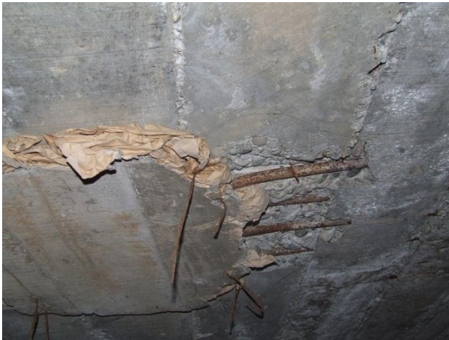
Figura 4. 20: Reparación mal ejecutada.
