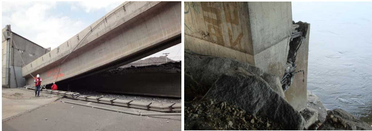
Figura 2. 16: A la Izquierda: Paso superior Lo Echevers, caída del tablero. A la derecha: Puente Juan Pablo II, daño en Cepa. Fuente: Ministerio de obras públicas, 2010.
