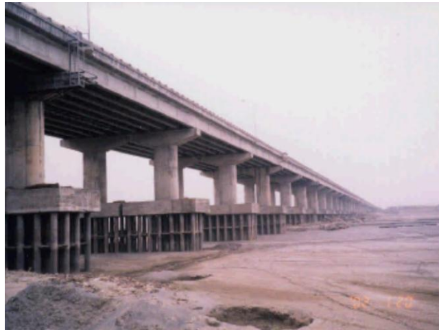
Figura 2. 12: Fundación del puente socavada once años después de terminada su construcción.
