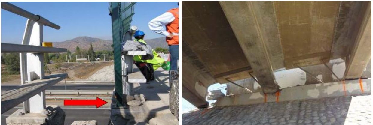
Figura 2. 14: A la izquierda: Puente cada, desplazamiento del tablero. A la derecha: Paso inferior las Mercedes, daño barras de anclaje. Fuente: Ministerio de obras públicas, 2010.
