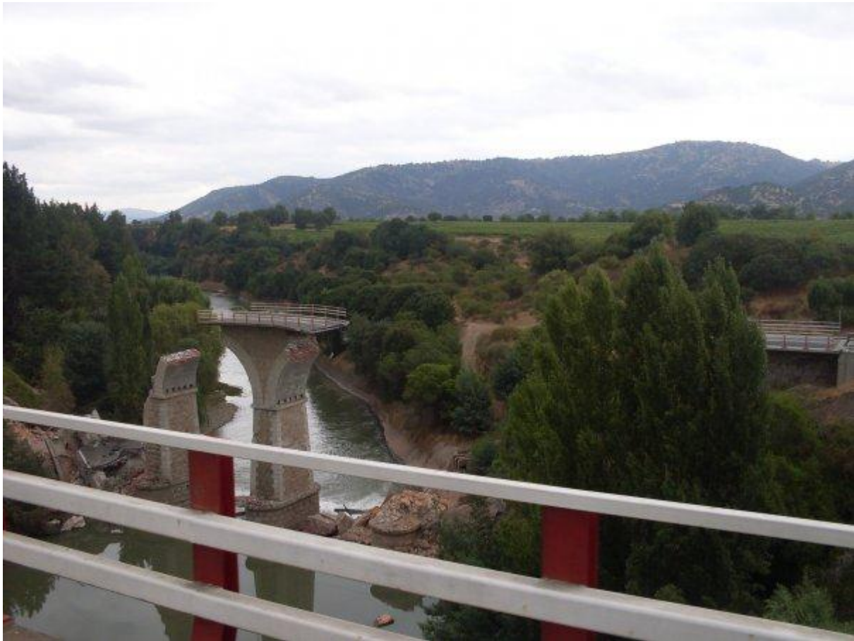
Puente Colapsado sobre el río Claro, Región del Maule.
