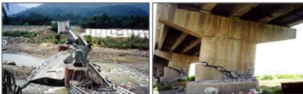
Figura 2. 10: Puentes dañados en el terremoto de Chi-Chi.
