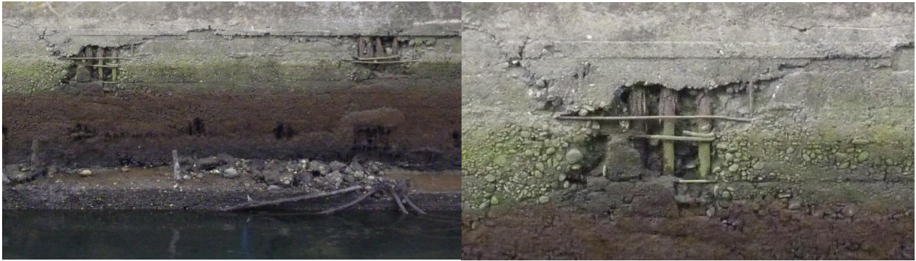
Figura 4. 25: Pilar extremo del lado poniente: A la izquierda: acero de refuerzo al medio ambiente. A la derecha: nido de piedra y armadura de refuerzo expuesta al medio ambiente.
