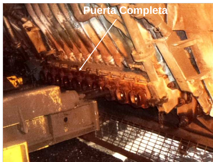
Figura 8.2. “Ubicación Toberas con Doble Silenciador, Puerta Completa”
