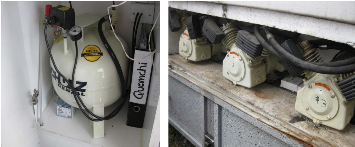
Figura 4.9: Compresor Schulz MSV 6/30 instalador en Clínica Dental Móvil. Se visualizan la separación de los acumuladores y motores.
