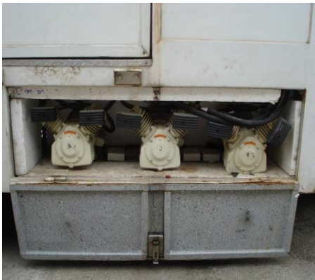
Compresores de aire
