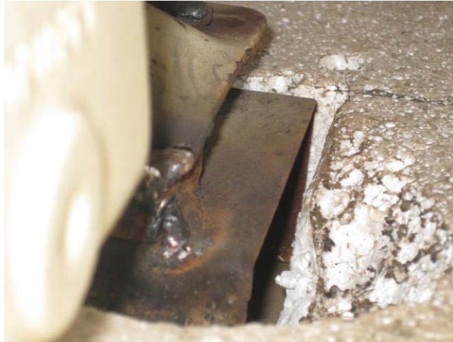
Figura 6.2: Fijación actual de uno de los compresores de aire mediante soldadura simple.
