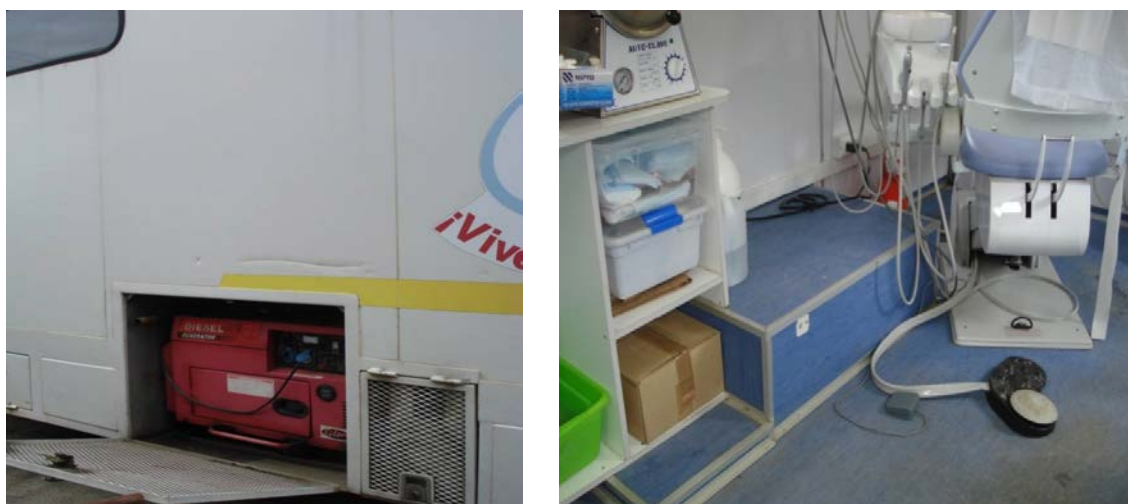
Figura 4.11: Vista exterior e interior del lugar del gabinete de instalación del Generador en Clínica Dental.
