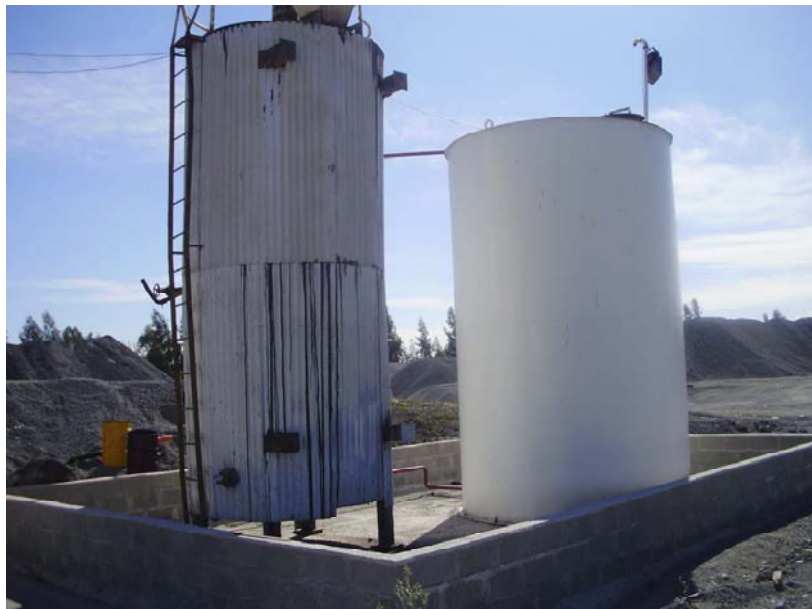
Fotografía 1.5: Visualización estanque con solución asfáltica al costado de la planta de asfalto.
