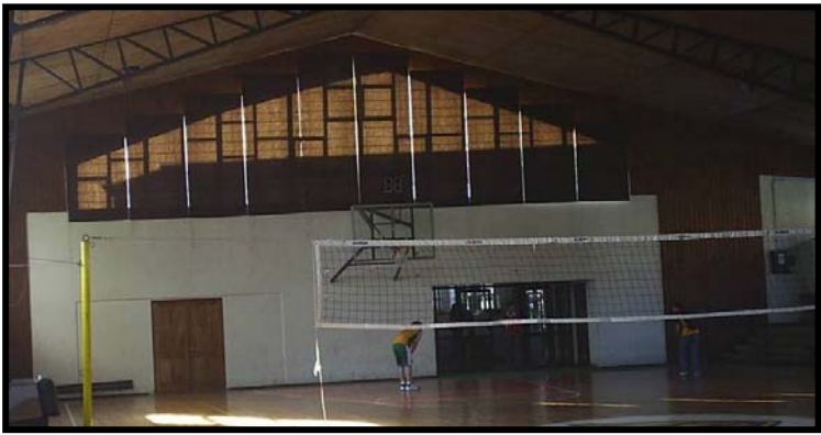
Figura 11: Frontón lado sur poniente, ventanales con vidrios simples y forro de tablas de pino.
