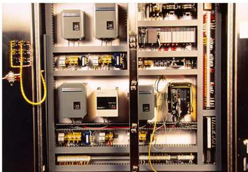
Figura N° 111. Tablero armado utilizando buses de campo.
