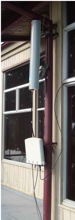
Fotografía 8.1 BS instalada, vista 1
