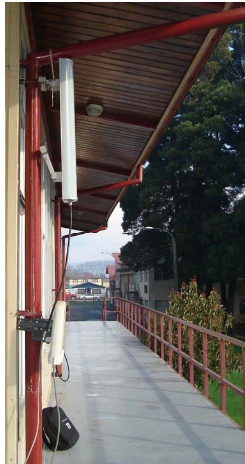
Fotografía 8.2 BS instalada, vista 2
