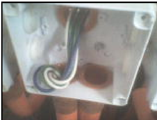
Figura N° 4.21 Distribución hacia tablero de cámara
