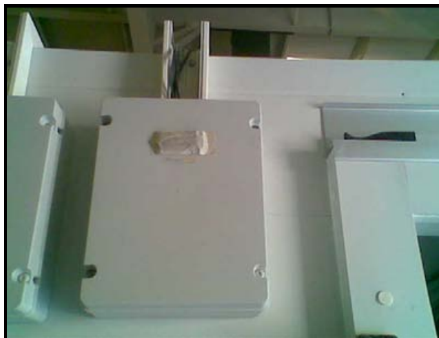
Figura N° 4.15 Tablero de cámara instalado
