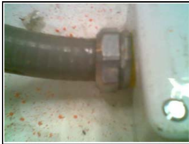
Figura N° 4.11 tubería flexible conectada a Caja de derivación de cubierta
