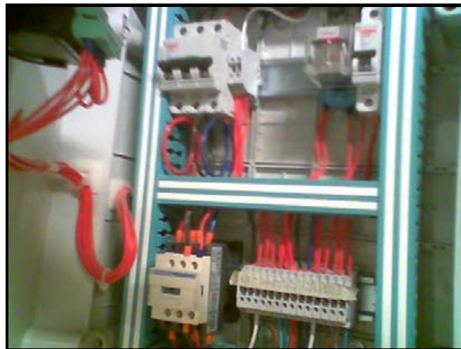
Figura N° 4.30 Conexiones en el tablero de cámara.
