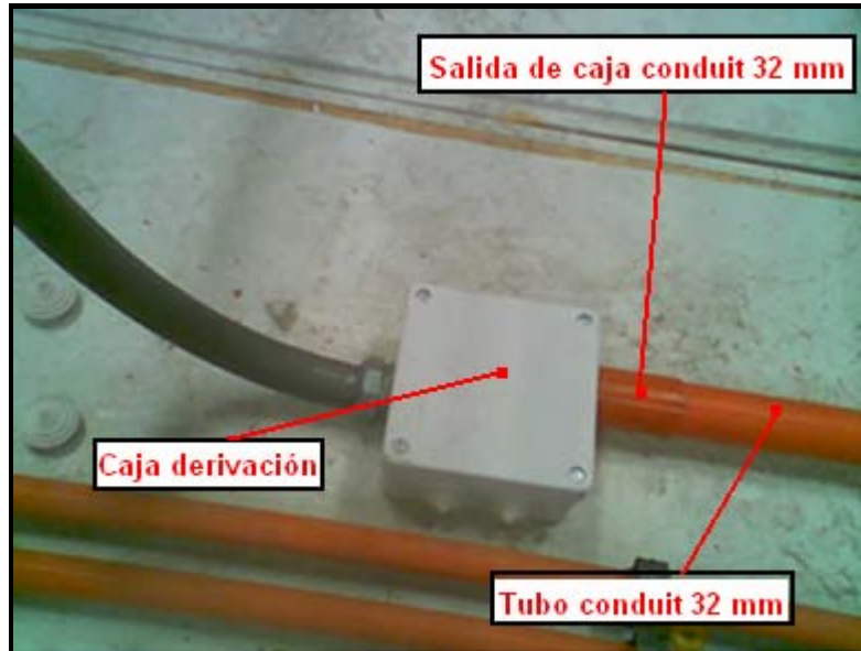
Figura N° 4.12 Conexiones a caja de derivación sobre cubierta
