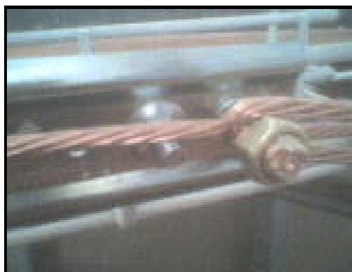
Figura Nº 4.23 Cable a tierra en escalerilla
