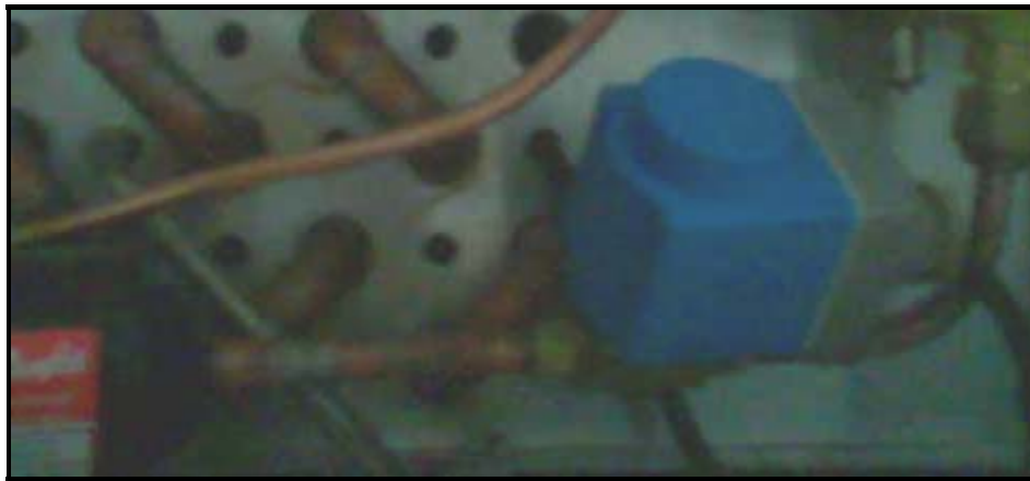
Figura N° 3.66 Válvula solenoide instalada.
