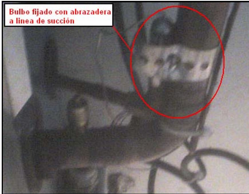
Figura N° 3.68 Bulbo instalado en línea de succión (aspiración)
