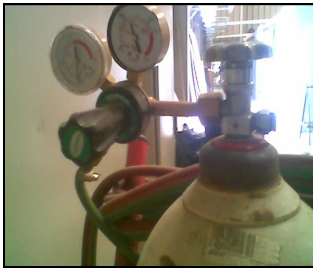
Figura N° 3.37 Reguladores de presión Oxígeno
