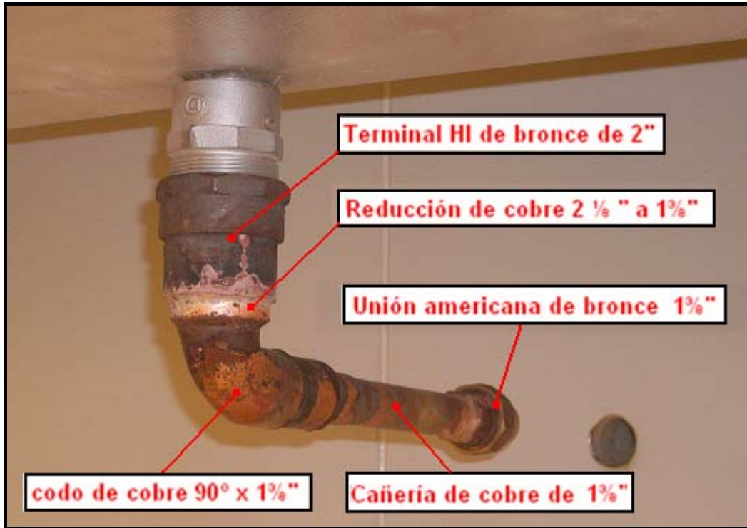
Figura N° 3.92 Desagüe de baja temperatura
