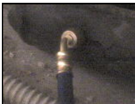
Figura Nº 3.104 Conexión bomba de vacío
