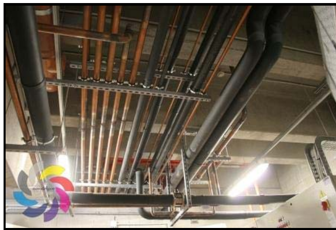
Figura N° 3.18 Aislación en tuberías línea de succión.
