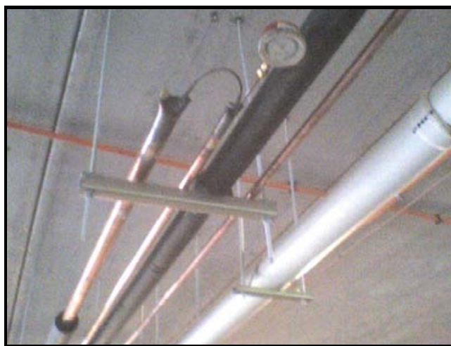
Figura N° 3.1 Presurización a 20 bar.
