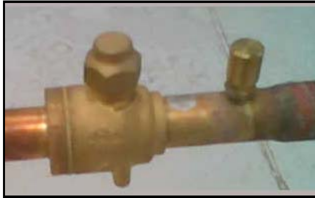
Figura N° 3.62 Válvula de bola instalada
