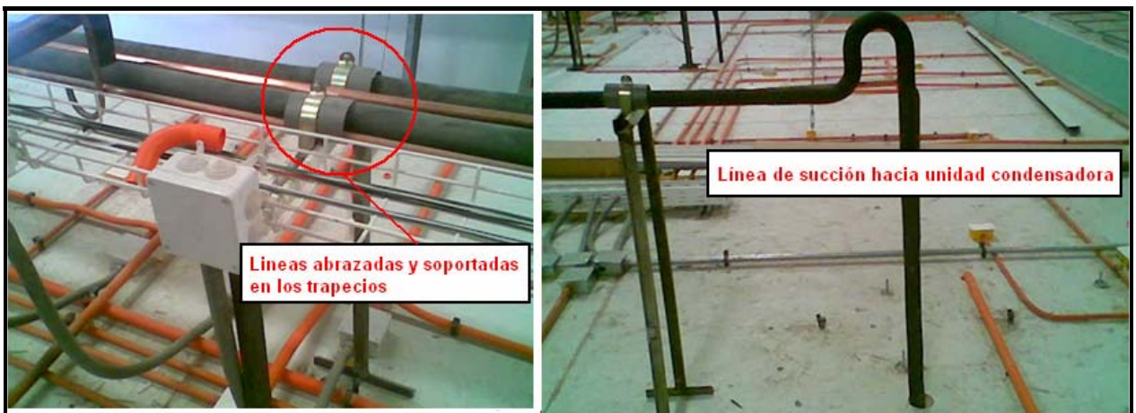
Figura N° 3.97 Líneas de líquido y succión hacia unidad condensadora
