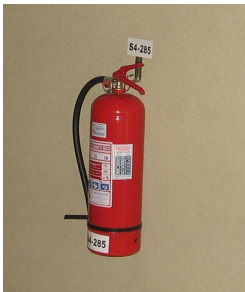
Figura N°37, Extintor tipo polvo químico ABC ubicado en el 2º piso.
