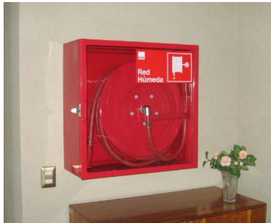
Figura N°28, Red húmeda 3° piso.
