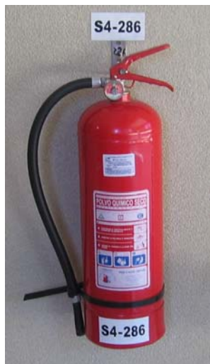
Figura N°20, Extintor polvo químico ABC 6 kg.
