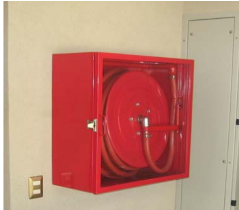
Figura N°38, Red húmeda ubicada en el 1° piso.
