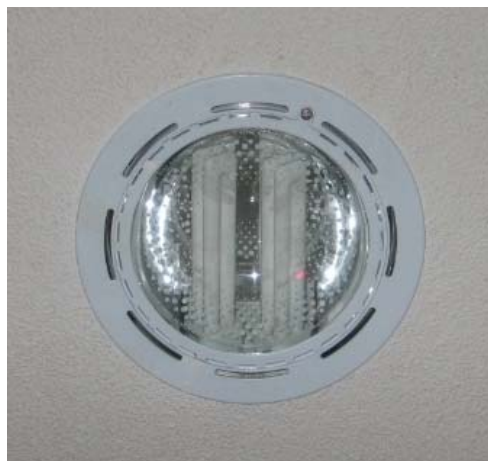
Figura N°39, Luz de emergencia ubicada en los pasillos de los 3 pisos.
