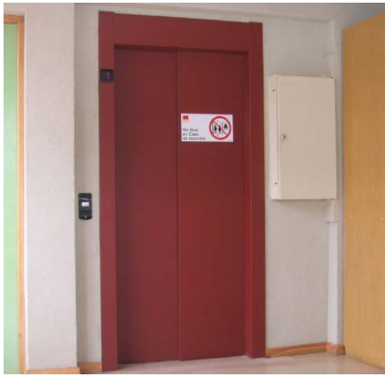
Figura N°26, Ascensor ubicado en el 3° piso.
