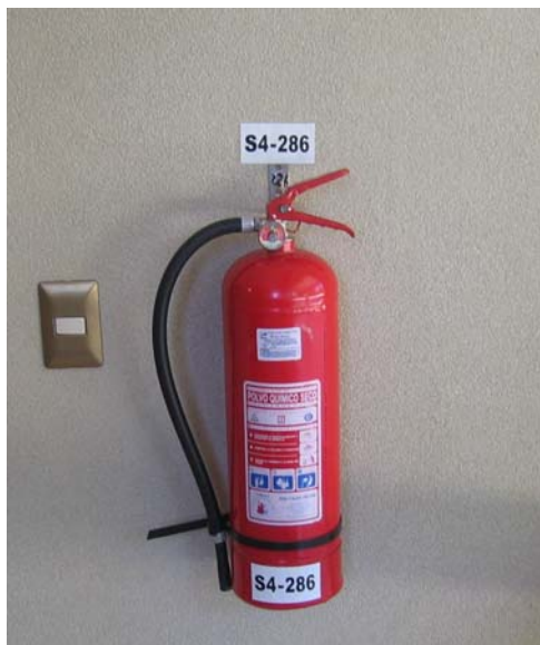
Figura N°36, Extintor tipo polvo químico ABC ubicado en el 1º piso.
