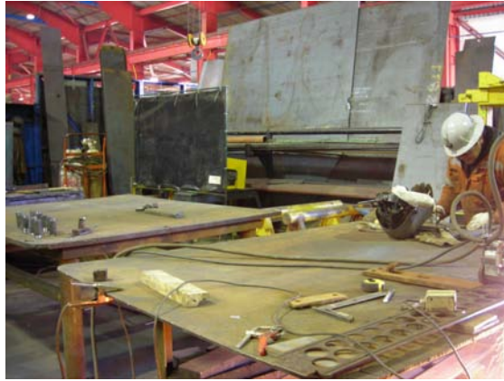
Fig.5.5. Sala de soldaduras.
