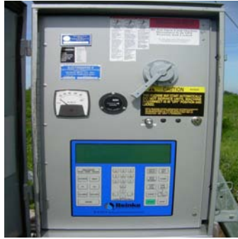
FIGURA N° 22 Tablero de control automático del equipo.
