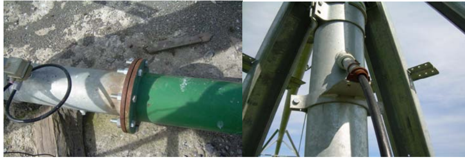
FIGURA N° 16 Unión tubería conducción a pivote, conexión cable eléctrico a tubería entrada de agua.
