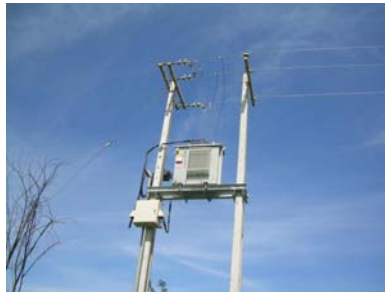
FIGURA N° 19 Transformador del sistema de riego.
