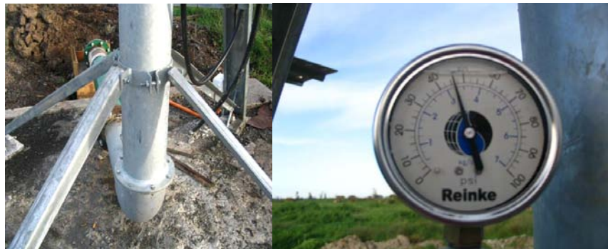
FIGURA N° 15 Vista entrada del agua al pivote y manómetro.
