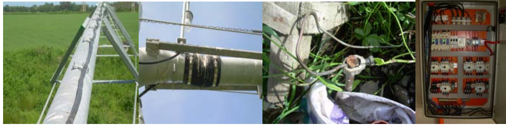
FIGURA N° 20 Sistema de alimentación eléctrica del pivote.
