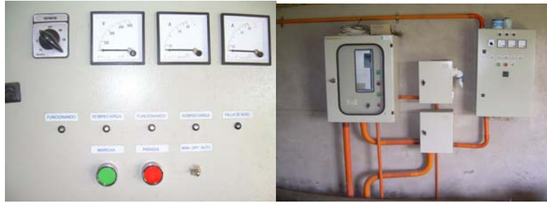
FIGURA N° 21 Tablero de comando y control de las motobombas.
