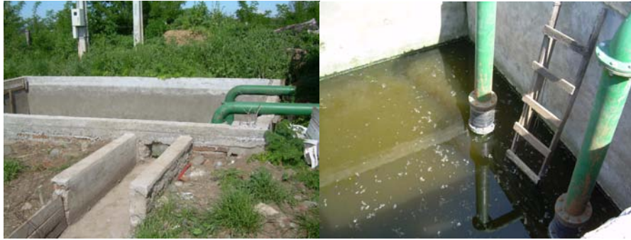
FIGURA N° 4 Acumulador de agua.
