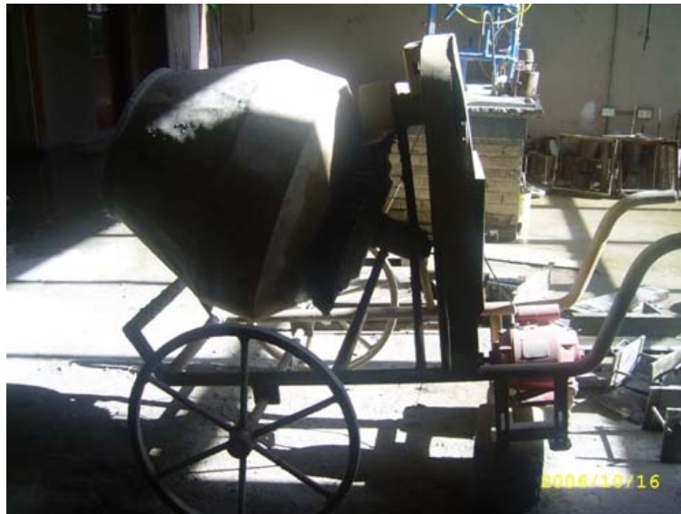
Betonera para confeccionar las mezclas
