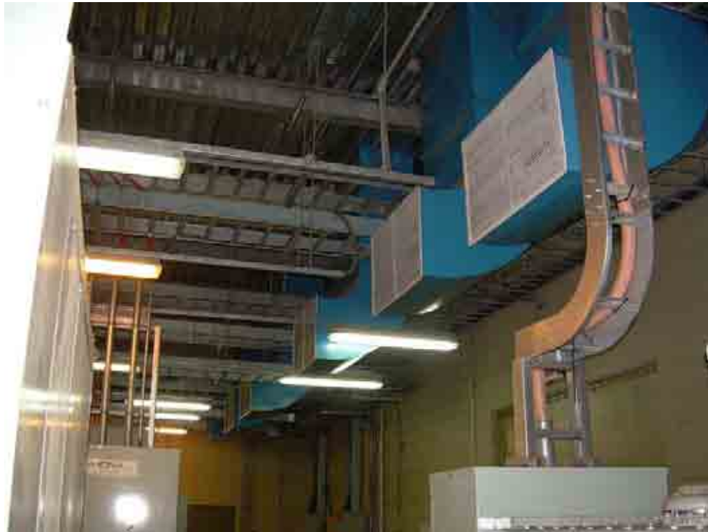
Figura 2.1. Bocas de impulsión de aire ubicadas dentro de la sala.
