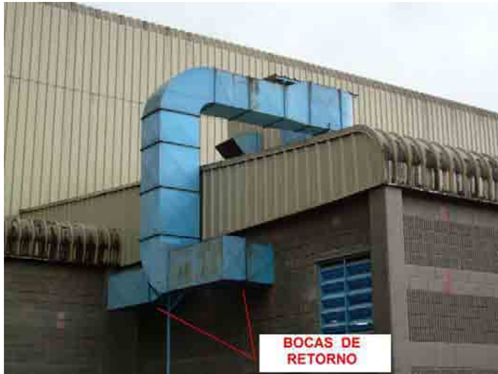
Figura 2.2. Vista exterior del conducto de retorno.
