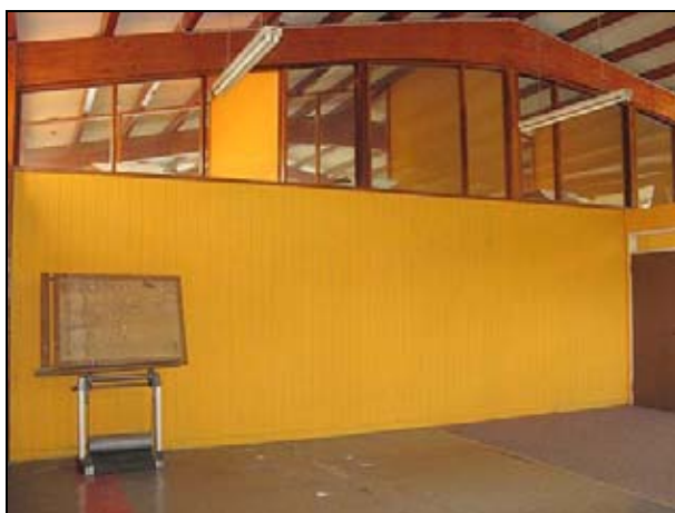
Figura 82: Fotografía de sala piloto, Zona D.
