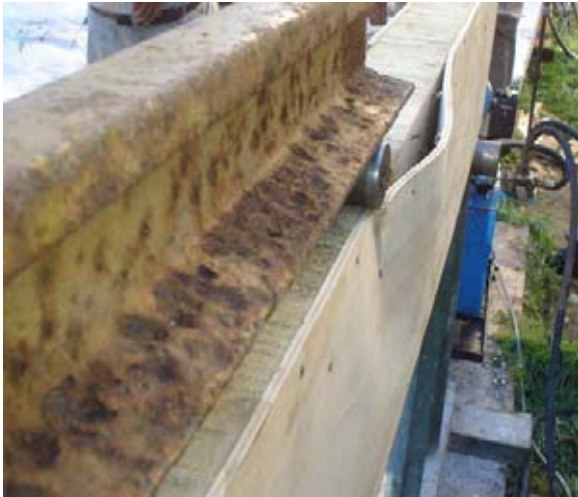
Viga 6 (VC 5,2): (Falla producida por el desprendimiento del contrachapado)
