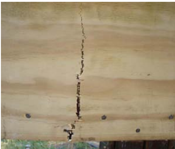
Viga 5 (VC 9): (Falla del contrachapado en el tercio central de la luz de ensayo)
