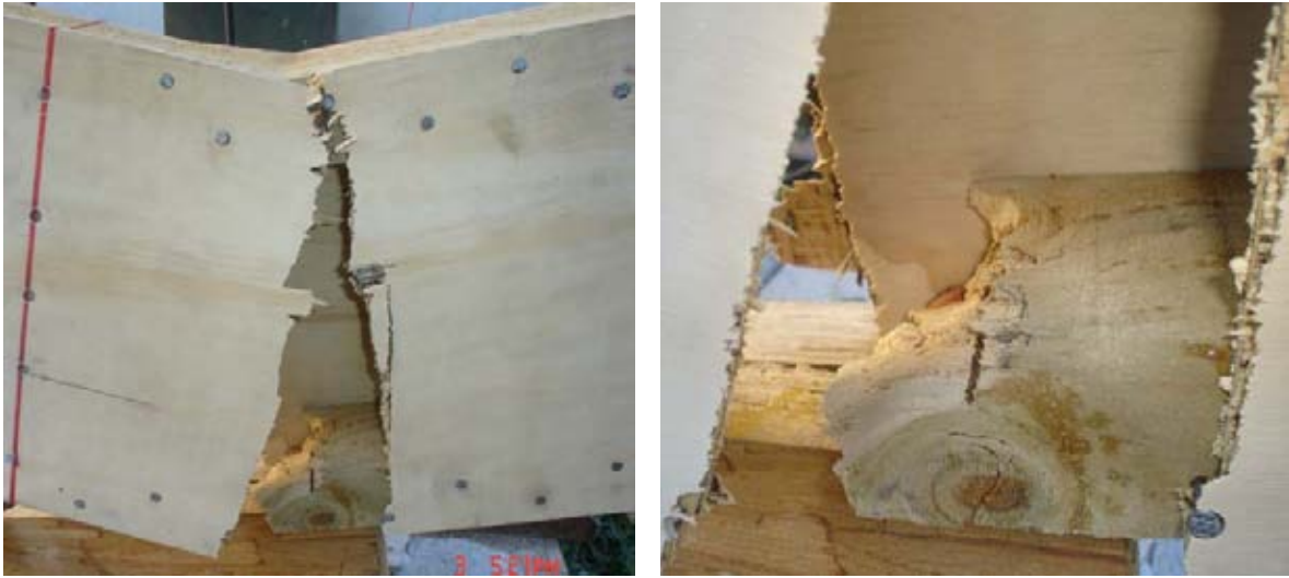
Viga 6 (VC 9): (Falla de madera y contrachapado por la presencia de un nudo)
