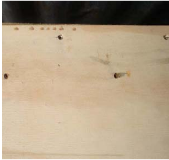
Figura 7. Desprendimiento del contrachapado en vigas VC 5,2 por falla tipo II.
