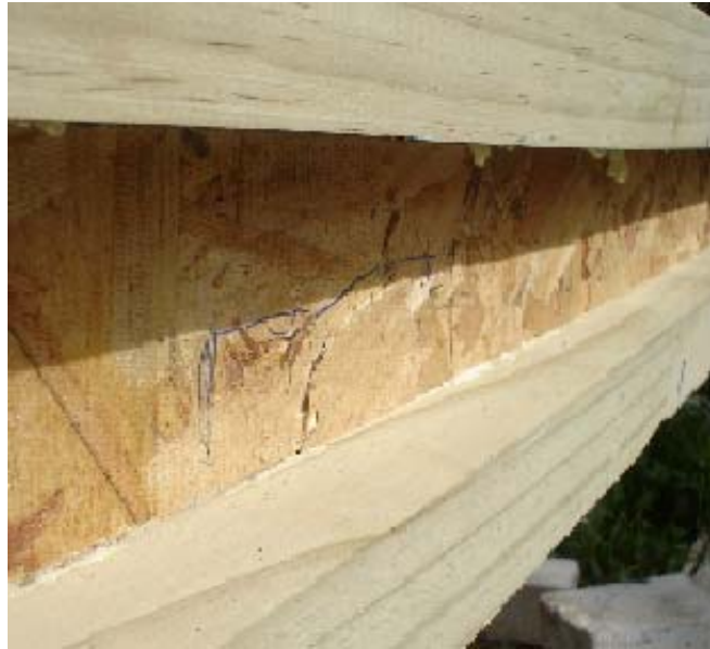
Figura 15.Falla Alma OSB por corte.
