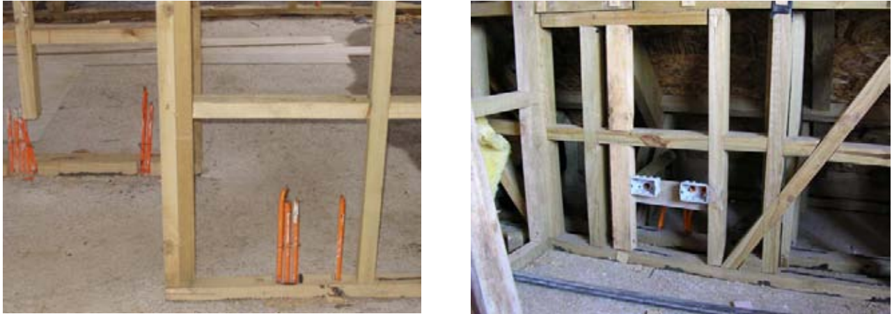
Figura 20: canalización eléctrica en estructura de 2° piso
