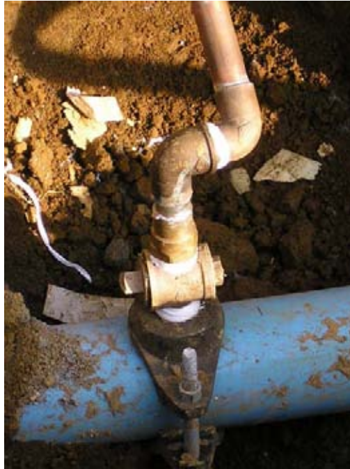
Figura 3: Arranque de agua potable
