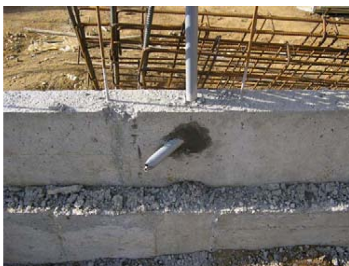
Figura 13: tuberías en sobrecimiento
