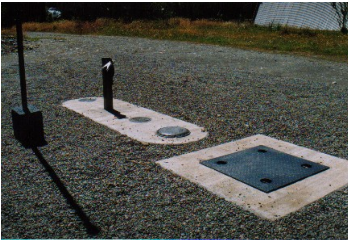
En la fotografía se aprecia la tapa de la Cámara Domo, a continuación la descarga con su contenedor de derrames, luego la toma de tierra para conectarla al camión abastecedor.
