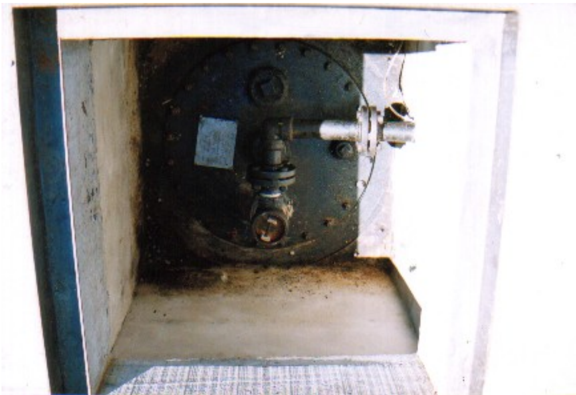
En la fotografía una Cámara Domo de una instalación de Fuel Jet, en esta está ubicada la succión, con flanges que permiten destapar el estanque para realizar su limpieza interior.
