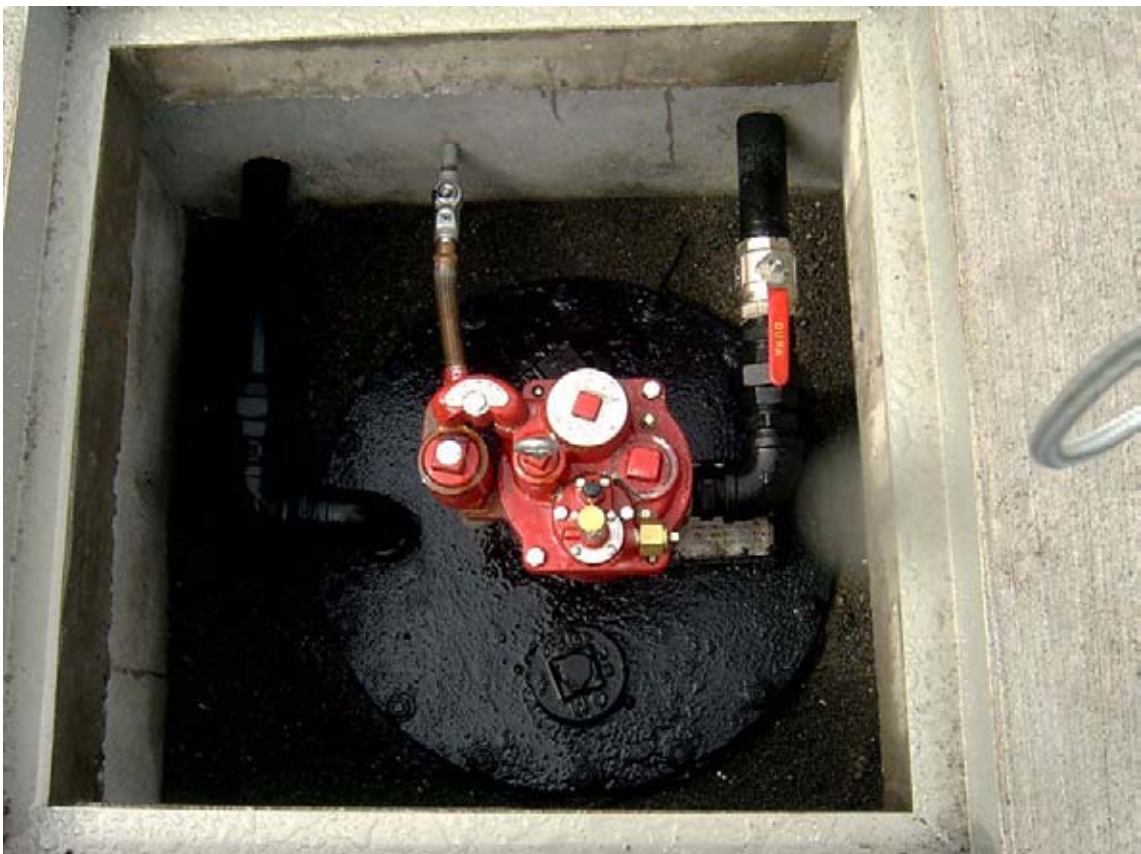
En la fotografía una Cámara Domo en la que se instala una Bomba sumergida, seguida de los elementos antes descritos.
