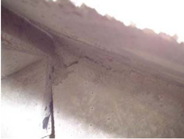
fig. No 57 Grietas visibles en los perfiles a los 4.000 kg de carga.
