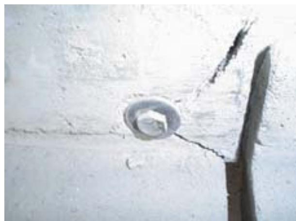
fig. No 56 Grietas concentradas en perforaciones de los pernos.
