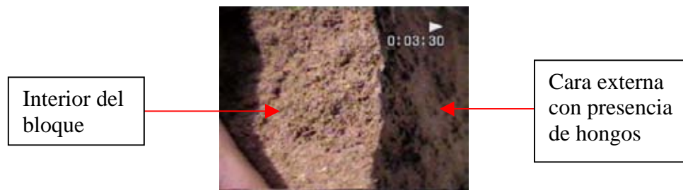
Foto n° 39 corte de bloque con presencia de hongos.
