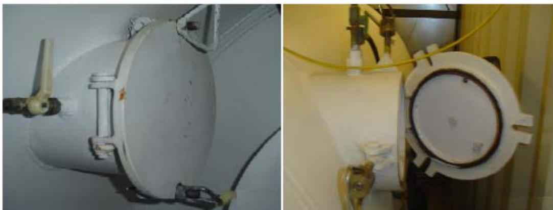
FIGURA N° 2-10 Vista interior y exterior esclusa paso medicamentos.
