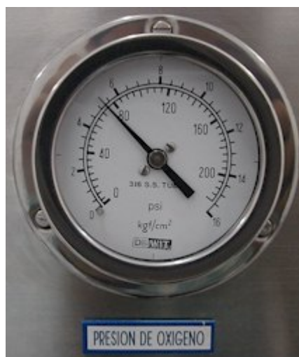
FIGURA N° 2-30 Manómetro presión de oxígeno.
