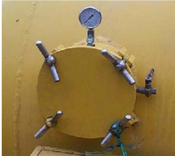
FIGURA N° 2-11 Manómetro exterior montado en esclusa.
