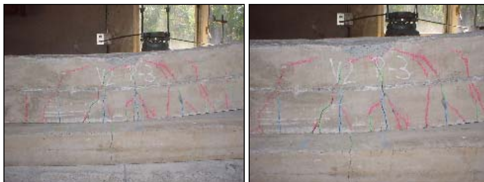
Foto 4.1 2 Grietas viga 1 prototipo
