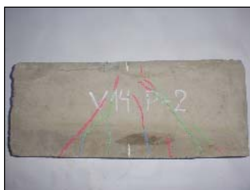
Foto 4.1 12 Grietas viga 3 prototipo
