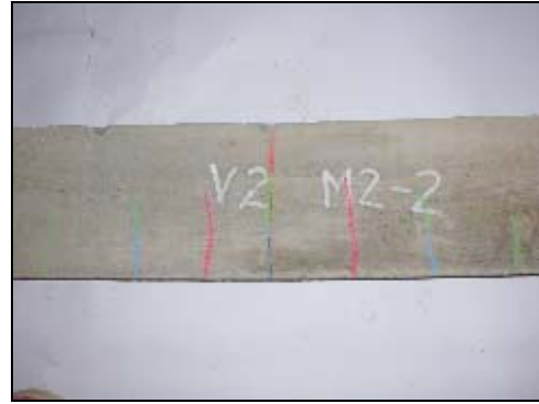
Foto 4.1 4 Grietas viga 1 modelo 2
