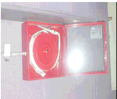
Gabinete con sistema de carrete
