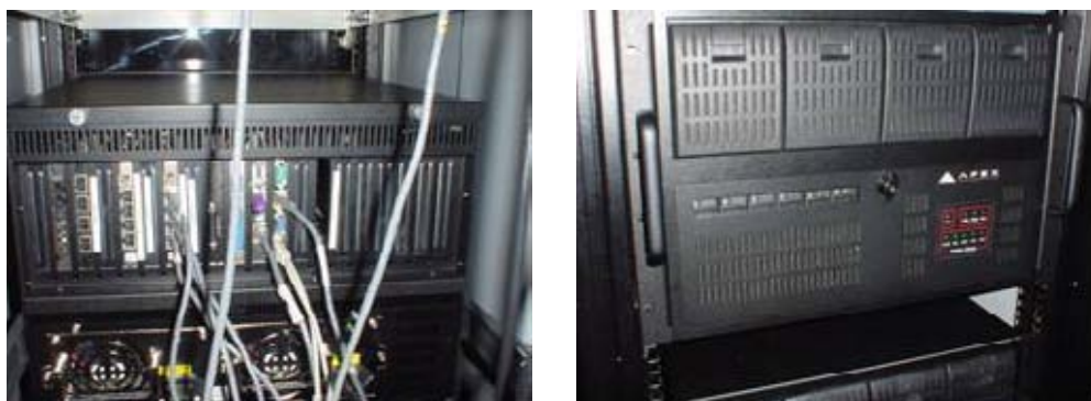
Figura 3.2.1-A: Fotografías de Servidor IVR, plataforma APEX Telefónica del Sur.
