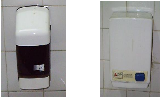
Dispensador de jabón y secador de mano eléctrico de los baños del personal. Junio 16, 2004.
