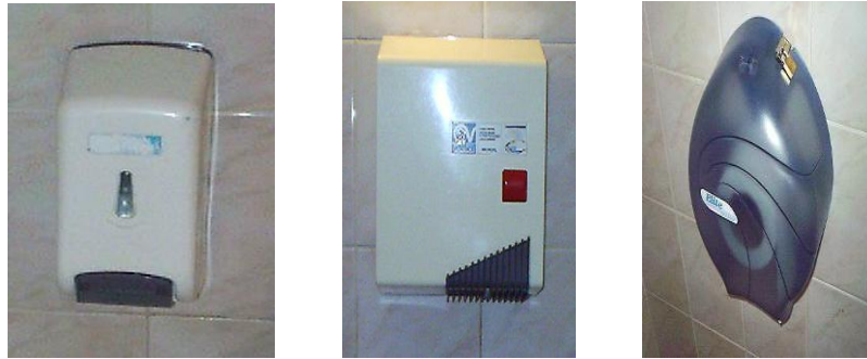
Dispensador de jabón, secador de mano eléctrico y contenedor de papel higiénico de los baños públicos. Junio 16, 2004.
