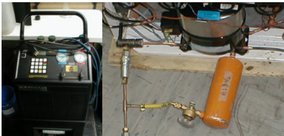
FIGURA N°5.4, Equipo de Carga
