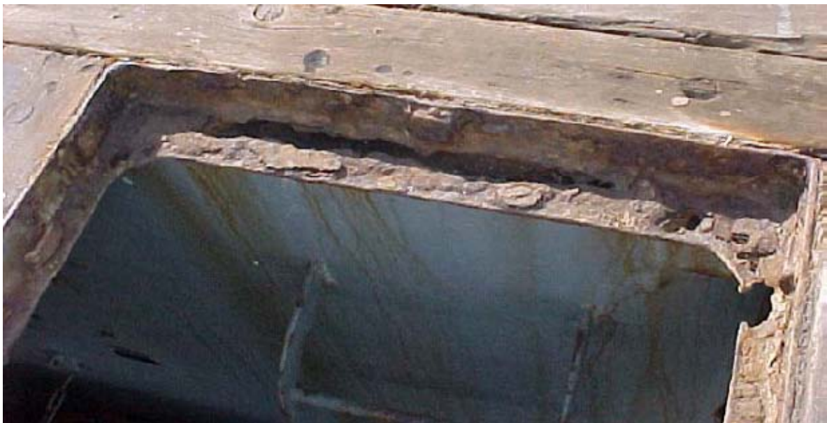
Perdida de material por altos niveles de corrosión en la escotilla.
