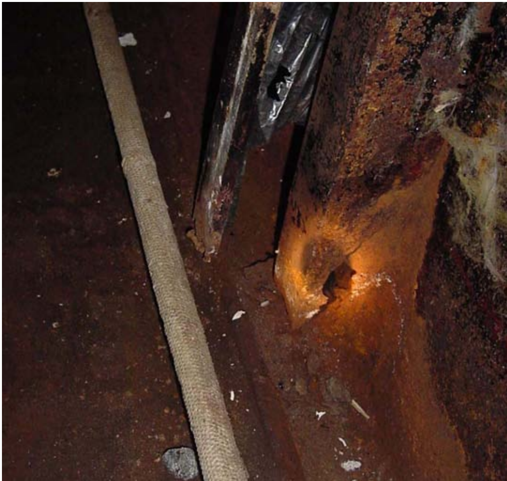
Perdida de material por altos niveles de corrosión el refuerzo vertical del mamparo.
