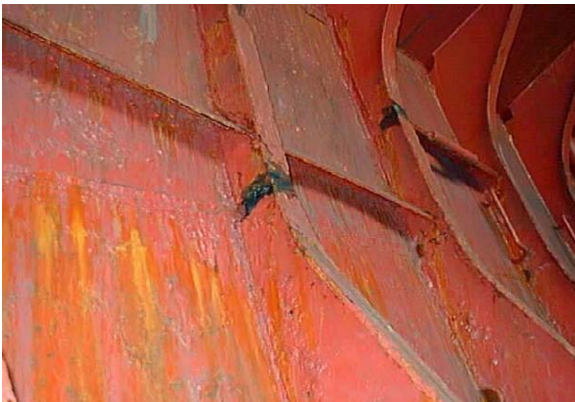
Grietas en cambio de sección en cuadernas de bodega.
