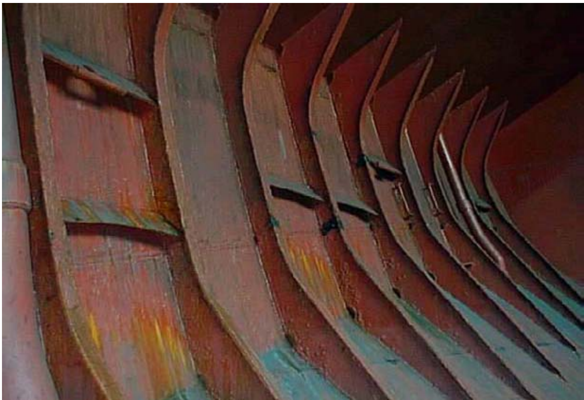
Grietas en cambio de sección en cuadernas de bodega.
