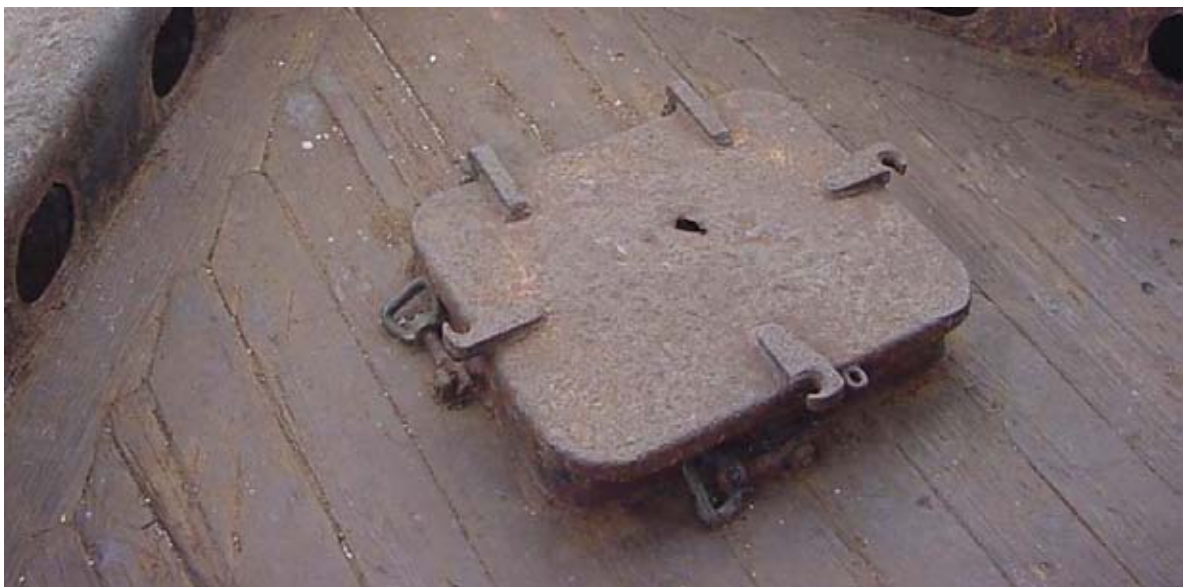
Evolución de la corrosión.
