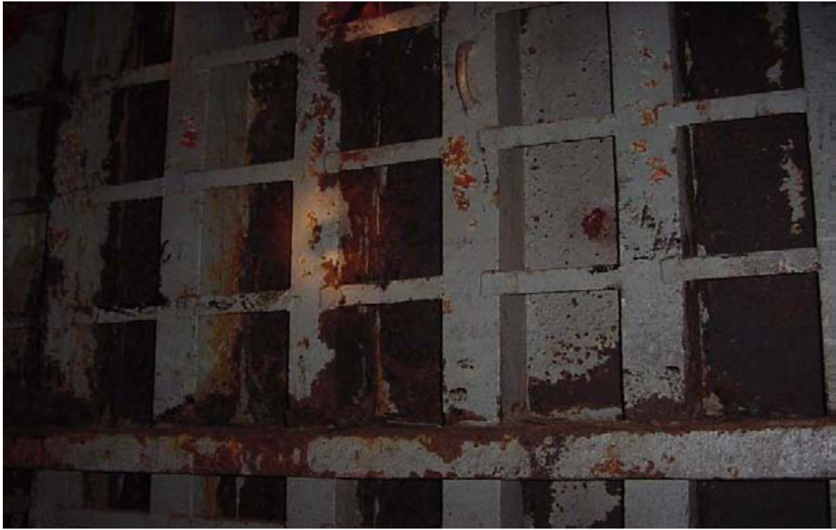
Corrosión en bodega por presencia de humedad.
