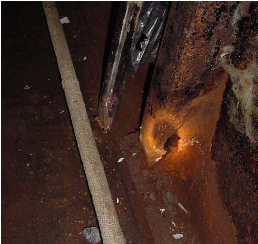
Perdida de material por altos niveles de corrosión el refuerzo vertical del mamparo.
