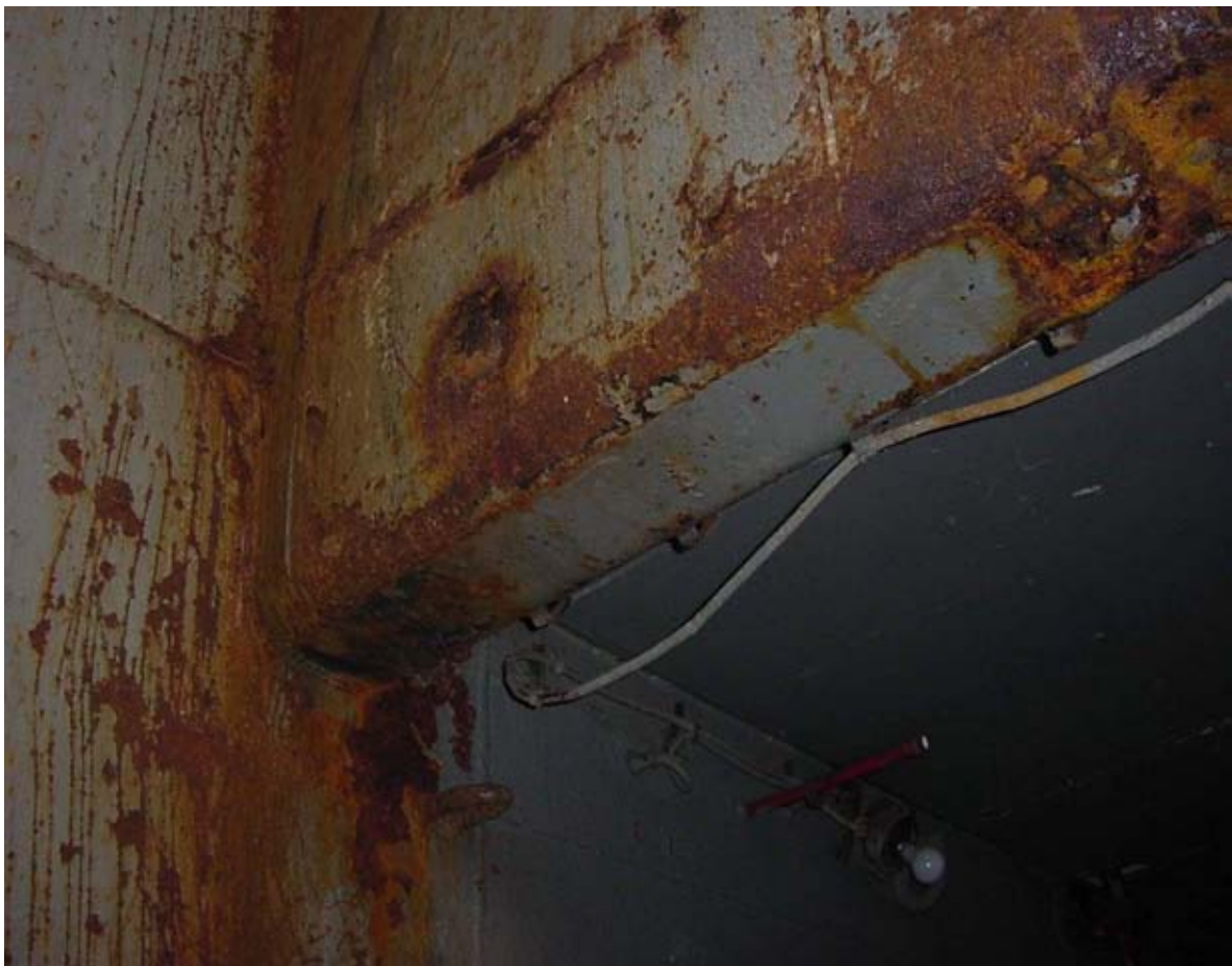
Evolución de corrosión.
