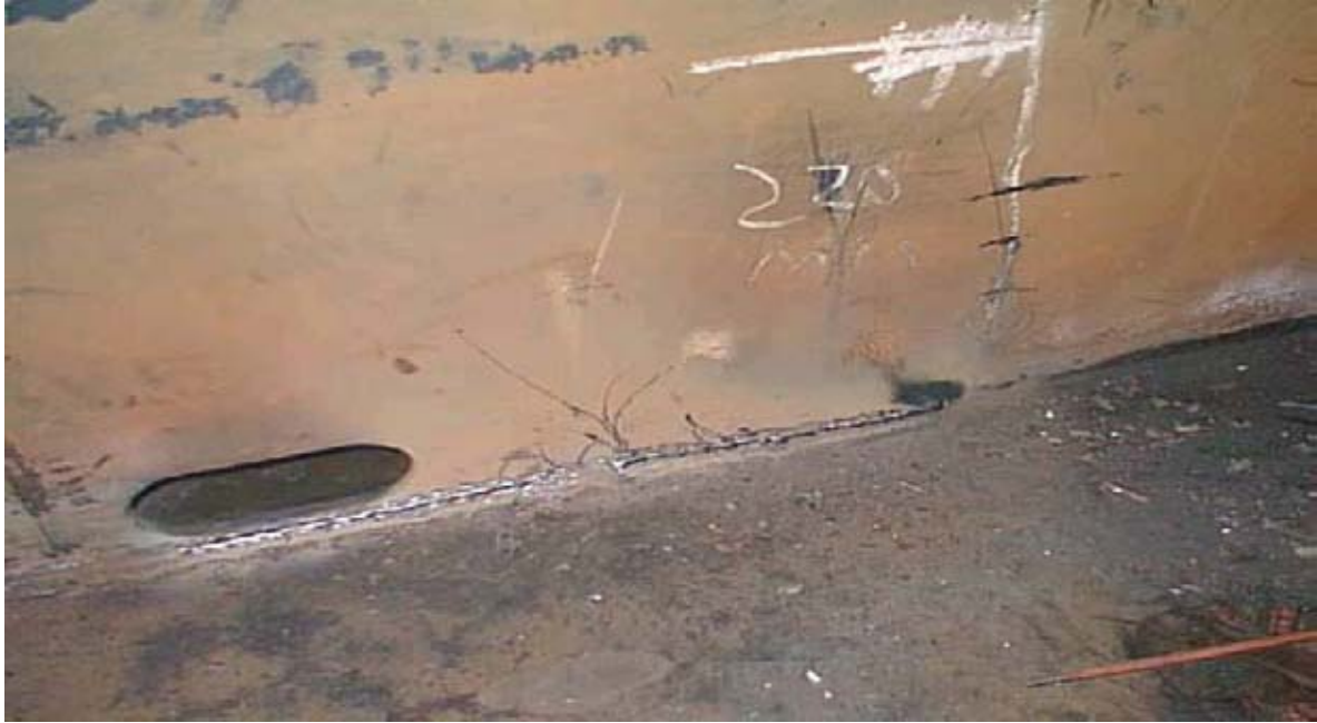
Aberturas que provocan aumento de tensiones.
