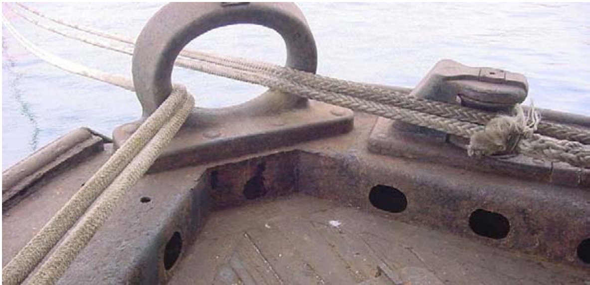
Corrosión bajo tensiones.
