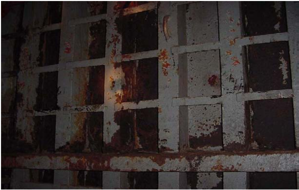
Corrosión en bodega por presencia de humedad.
