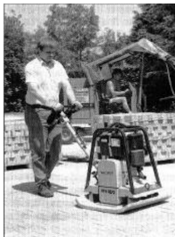
Fig 28. Vibración de un pavimento adoquinado
