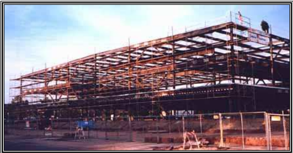
Figura 2.39 Centro de Operaciones del Area Norte de Pacific Bell (bajo construcción), Sacramento, California.
