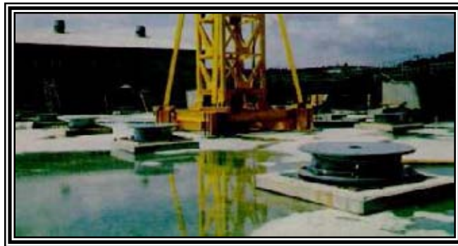
Figura 2.69 Instalación de los apoyos de goma de alto amortiguamiento en el Centro de computación N°2 de la Tokyo Electric Corporation.
